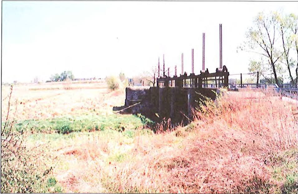
Fot. 4. Pozostałości urządzeń piętrzących wodę na Brynicy około 2 km poniżej zapory czołowej zbiornika Kozłowa Góra (fot. M. Rzętała). Photo 4. Remainings after water damming mechanisms on the Brynica about 2 km below frontal dam of Kozłowa Góra water reservoir (photo by M. Rzętała).
